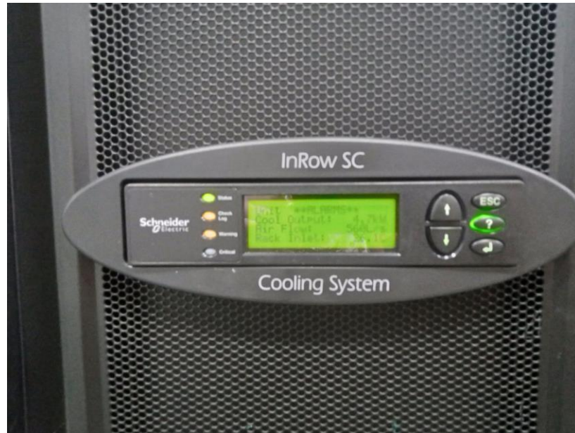
Gambar 2. Penunjuk Suhu pada perangkat Pendingin Ruangan
