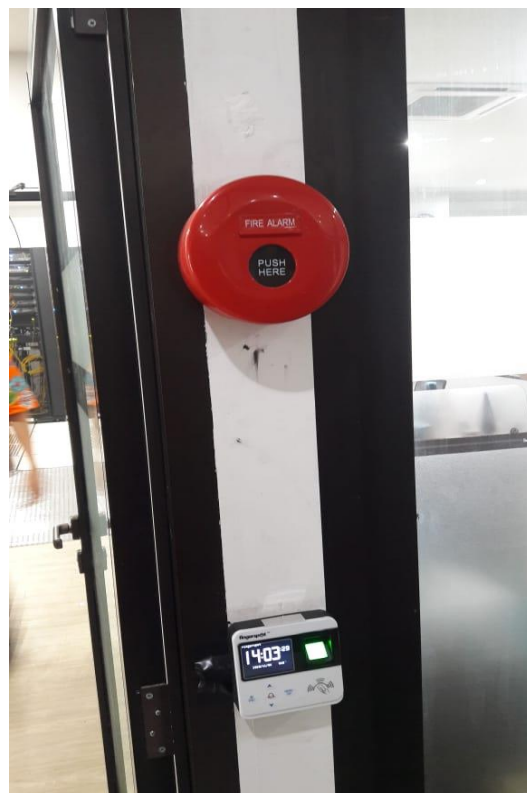
Gambar 3. Firealarm & Pintu Sidik Jari
